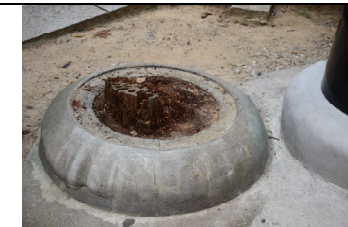
Encuentro de unión de piedra y pilar deteriorado en Fushimi Inari Taisha de Kioto
