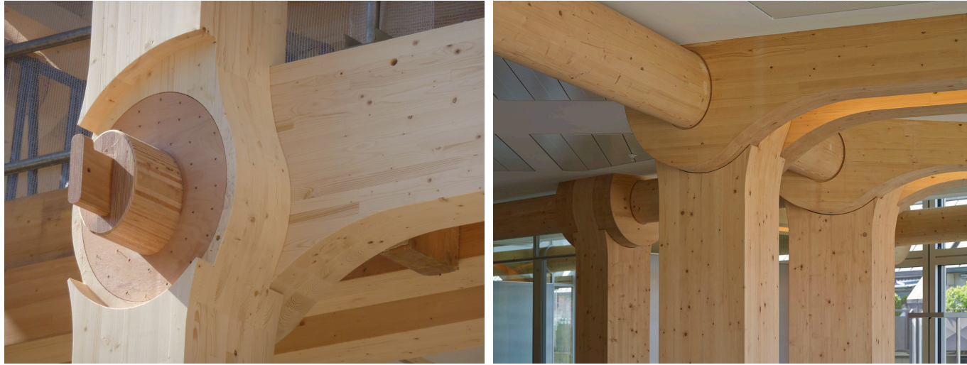
Figura 6: Detalle constructivo de edificio Tamedia en Suiza, diseñado por arquitecto japonés, Shigeru Ban.
