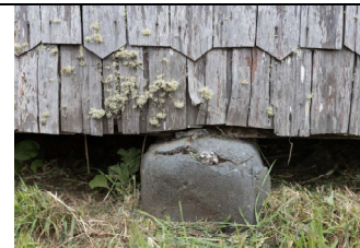
Encuentro de piedra de cimiento y solera inferior en iglesia de Vilupulli
