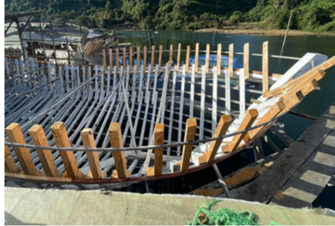
Figura 41: Proceso de construcción embarcación en San Juan, donde se aprecia a estructura de cuadernas que estructuran el casco de la embarcación. (2023)
