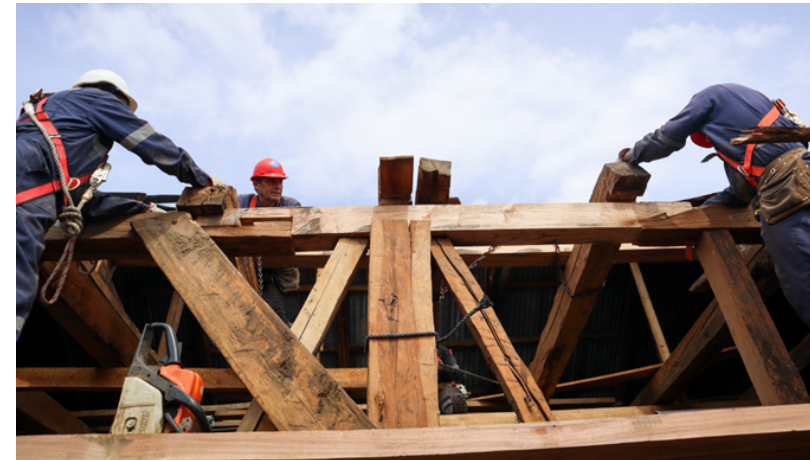
Figura 59: Proceso de restauración Iglesia de Chonchi, en la que se reemplaza sólo tramo dañado de solera superior de columnata, empalmando estos tramos con doble rayo de Júpiter y empalme de llave con traba. (2024)
