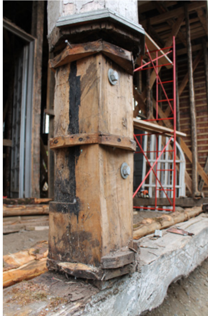
Figura 49: Pilar de pórtico de iglesia de Dalcahue con empalme a media madera y refuerzo de pernos. (2013)
