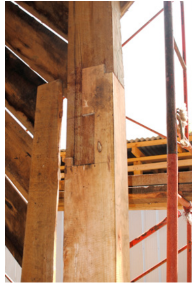
Figura 69: Unión de empalme utilizada en pie derecho en restauración de tabique culata iglesia de San Juan. (2021)
