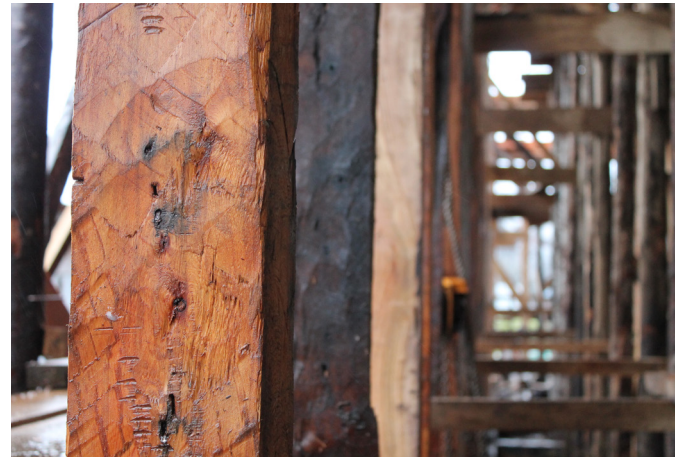
Figura 52: Iglesia de Nercón en proceso de restauración, con pies derechos instalados en su ubicación pre-existente.
